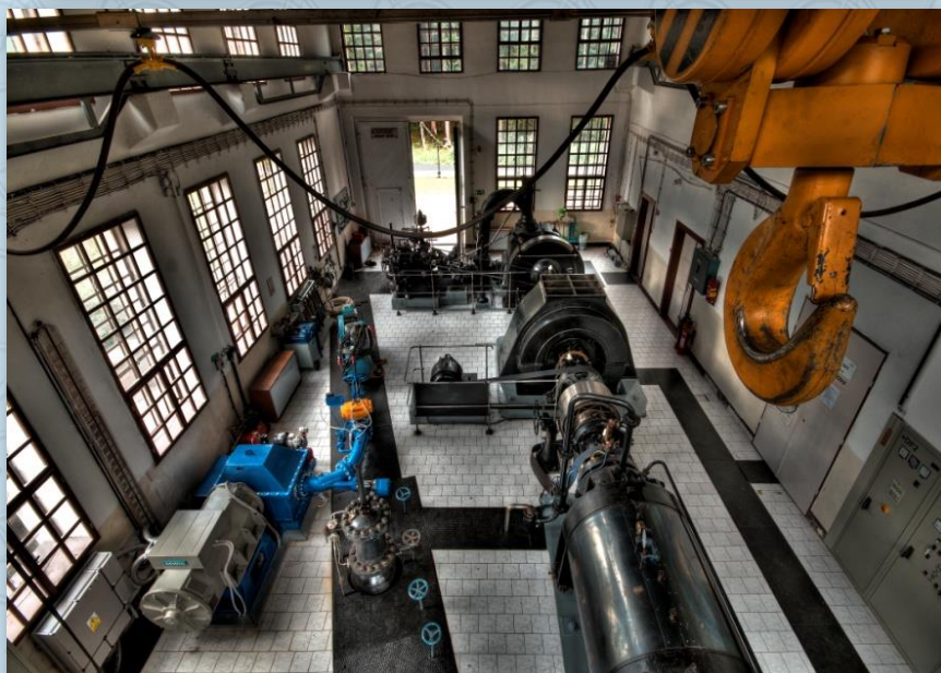
Elektrárna Černé jezero - vnitřek
